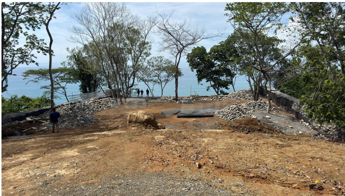
Figura 3. Area dónde se desarrollaba una construcción de gaviones detenida mediante orden administrativa No. SINAC-ACT-OSRC-001-2026.
